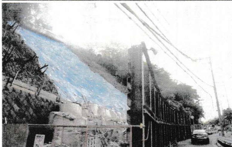
市に寄付されることになった崩落斜面。現在、斜面脇の市道中央部には高さ約4mの鉄製防護壁が設置されている —横須賀市ハイランド
